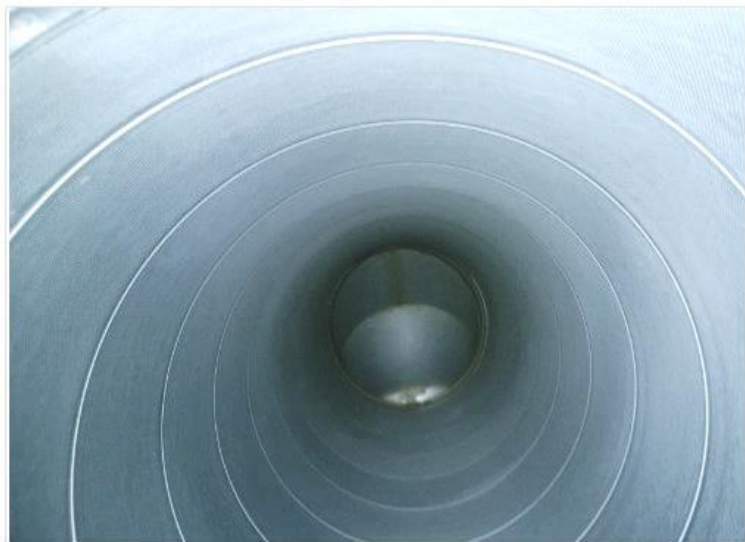
Restoran LaFamiglia, väljatõmbetorustik, L&T aruanne: pühkida pole vaja
